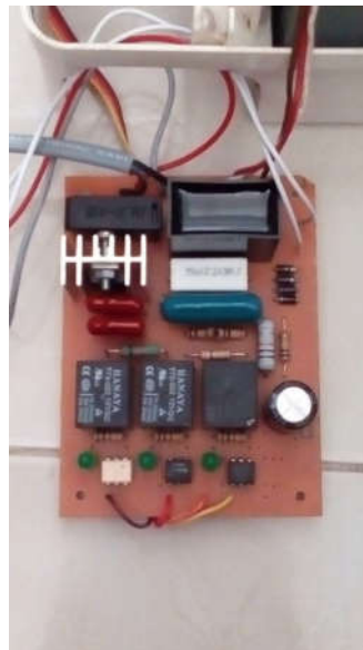
Gambar 6. Penyejuk Ruangan berhenti berputar
